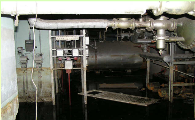
Τμήμα του πλημμυρισμένου υπογείου
