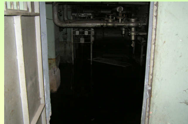
Τμήμα του πλημμυρισμένου υπογείου
